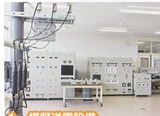
1 模擬送電設備
